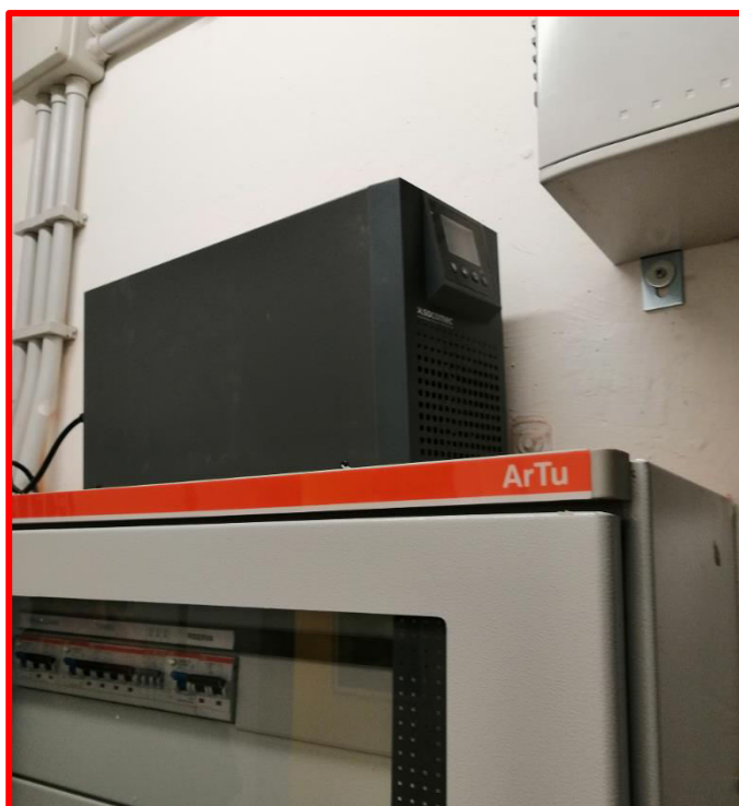
Dettaglio fotografico pannello di controllo gruppo di continuità (UPS) installato presso il vano tecnico
