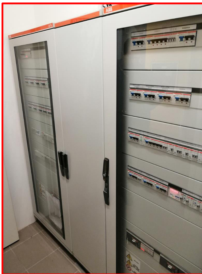
Quadro elettrico generale E1 piano terra
