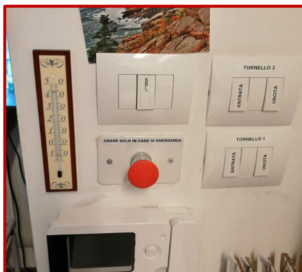
Sblocco d'emergenza sistema controllo accessi
