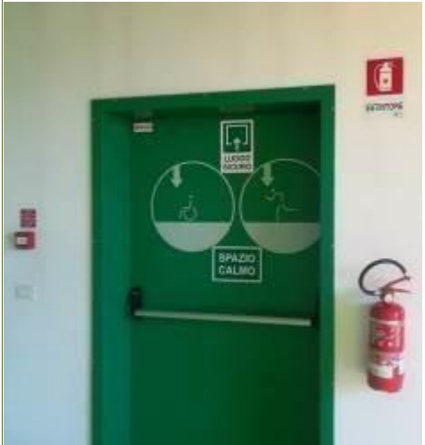
Identificazione uscite di sicurezza su scale di emergenza edificio
